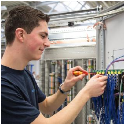
Das Steuerungsmodul wird verdrahtet
